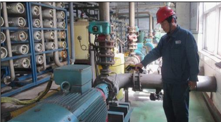
近日,热电厂化学车间针对即将来临的高温天,加强车间除盐泵、高压泵、冷水泵等辖区内所有泵类设备的巡检维护,同时加强运行岗位巡点检工作,以确保高温天气设备安全稳定运行。图为员工正在测量高压泵温度。摄影报道 杨苗
