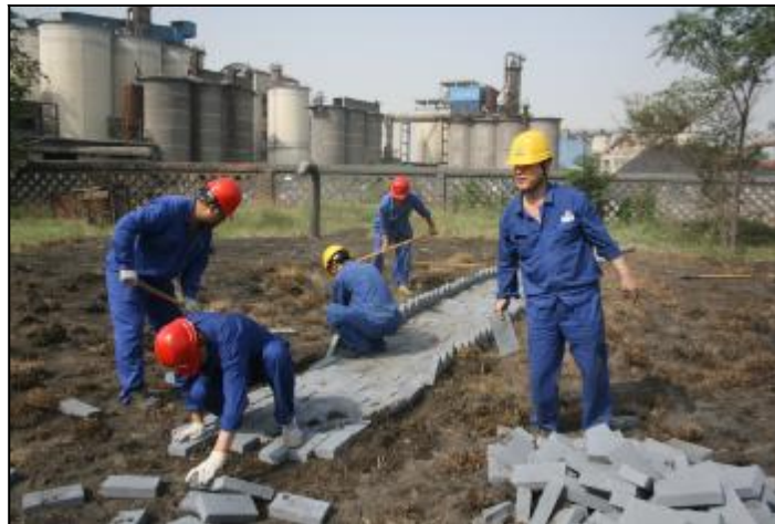
5月29日,水电分厂三车间组织人员为蓄水池溢流井点铺设巡检路线。一直以来,蓄水池溢流井点附近杂草丛生,由于没有水泥路面,一到雨季,巡检人员只能“披荆斩棘”和“跋山涉水”。为进一步改善员工巡检条件,车间党员干部及检修人员搬砖、拉车、铲除杂草、清理石头、平整路面,自己动手进行铺路。通过几个小时的努力,成功为清水泵房铺一条通往蓄水池溢流井点的巡检路。
