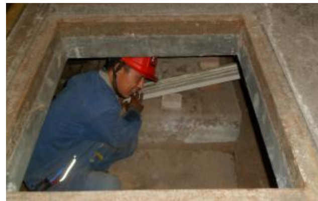
6月3日，水电分厂一车间组织技术力量检查各配电箱轴流风机、空调等降温设施，比照安规标准，对电缆进行检查、梳理、编号，保证夏季电力系统安全稳定运行。图为检修人员在狭小的电缆沟进行检查作业。摄影报道 张芳玲
