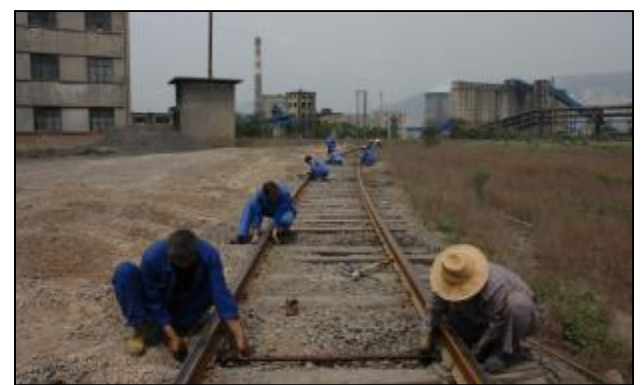
在持续高温的情况下,钢轨内部极易发生胀轨情况,如不及时对胀轨进行整修,将直接威胁行车安全。近日,运输部工讯段通过加强铁路巡查,及时对高温天气下的钢轨和线路进行整治,10名工讯段员工克服天气炎热、时间紧、任务重等不利因素,6小时内更换轨距拉杆20根,安装防爬器10幅,调整岔区轨缝7处,整修线路达200余米,保证了运输安全畅通。图为员工正在对原料站一号线防胀重点病害地段进行整修。摄影报道 尹峰
