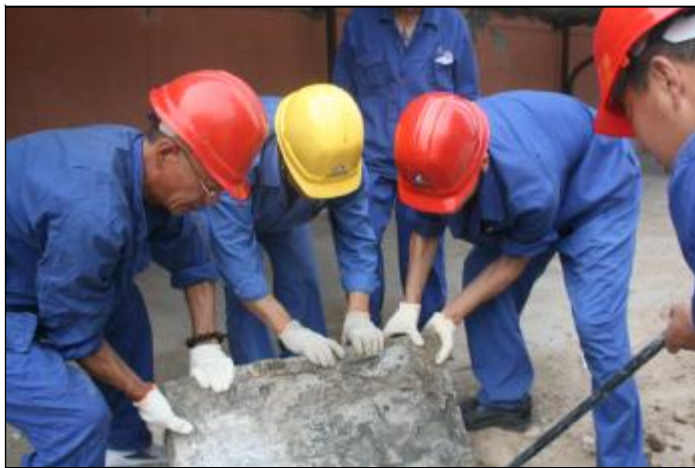
近日，水电分厂党委组织30名党员清理厂南泵房现场排水明渠。受前期清理工作影响，厂南泵房的排水明渠狭窄，且废料有结块，清理十分困难。30名党员撬盖板，挖淤泥，砸结块，疏通狭窄地带，经过3个多小时的劳动，共清淤泥10立方，为平稳度过汛期打好基础，也用实际行动为建党92周年献礼。图为党员在现场撬开厚重的水泥盖板。摄影报道 杜丙泽
