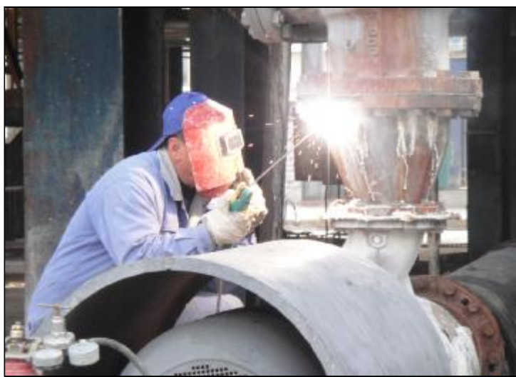
近日,第二氧化铝厂综合车间开展“自查自纠管理缺陷”安全标准化达标活动,对日常管理工作进行检查和整改。车间在全体管理人员中开展自查自纠讨论活动,提高管理人员的责任心和工作作风,以班组为单位,查找工作范围内的管理缺陷,并全面整改发现问题。
