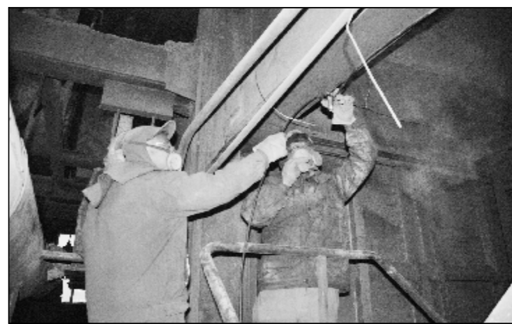
为确保“两节”期间的安全生产,近日,热电厂电气车间针对5号锅炉照明线路老化的现象进行彻底改造。检修人员克服现场作业环境复杂、灰尘大等困难,从零米到四十多米,对8条线路进行改造,更换电缆600多米、安装海洋王灯具30余套。图为检修人员正在更换照明线路。
