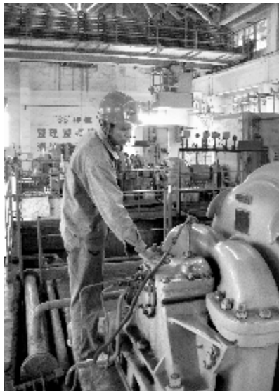
图为员工正在测量空压站温度及振动情况,确保设备正常运转。 摄影 张利
