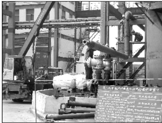
经过前期的紧张施工,目前,第二氧化铝厂4号焙烧炉烟气余热利用项目进入收尾阶段,项目配套散热器、水泵、配套风机及循环水管道系统等进入最后的安装调试阶段,预计7月初可带负荷试车。该项目建成后,不仅能产生可观的经济效益,同时可大大减少4号焙烧炉热量排放,减少环境污染。摄影报道 李清波
