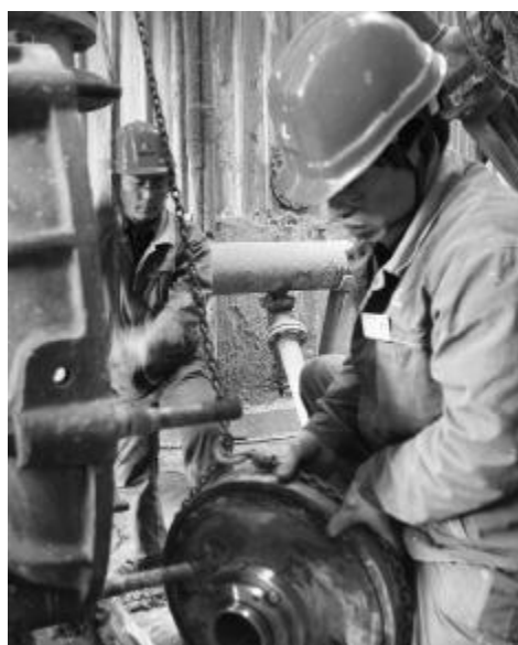
近日,80万吨氧化铝厂点检站主动承担辖区内一些急、险、重的设备检修工作,截至目前共清理废料100余方,处理设备故障10余起。图为点检员正在对返料泵更换机封。摄影报道 吴旭龙 韩宏建
