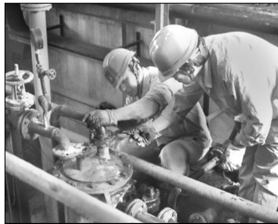
7月份,氧化铝一分厂检修车间积极开展高温高压设备的点检维护,保证设备安全稳定运行。图为检修员工正在维护高压风压缩机冷却系统。摄影报道 杨俊廷
